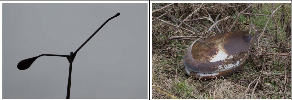
Състояние на осветителните тела на път I-6 между гр. Кюстендил и с. Ябълково
