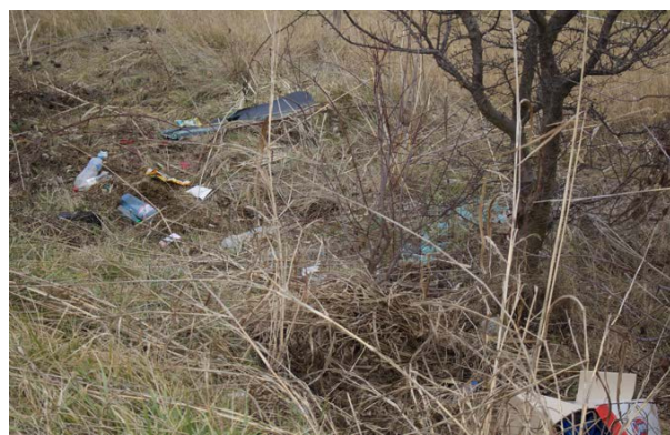
Състояние на земните окопи ляво платно на път I-6 с (с. Ябълково → гр. Кюстендил)
