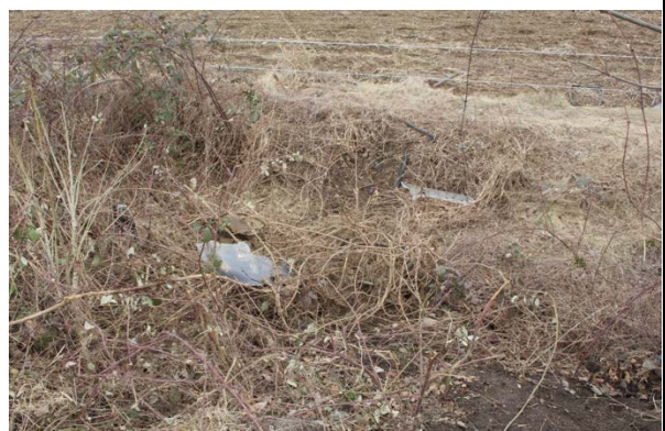
Състояние на земните окопи дясно платно на път I-6 с (гр. Кюстендил → с. Ябълково)
