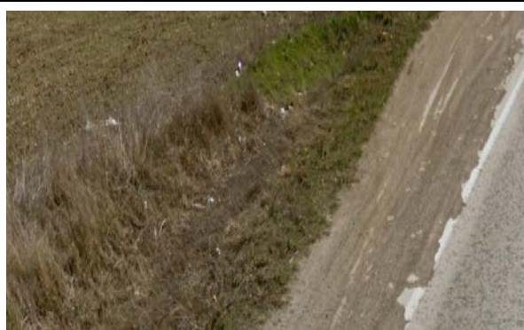
Състояние на земните окопи дясно платно на път I-6 с (гр. Кюстендил → с. Ябълково) към 2012 г.
