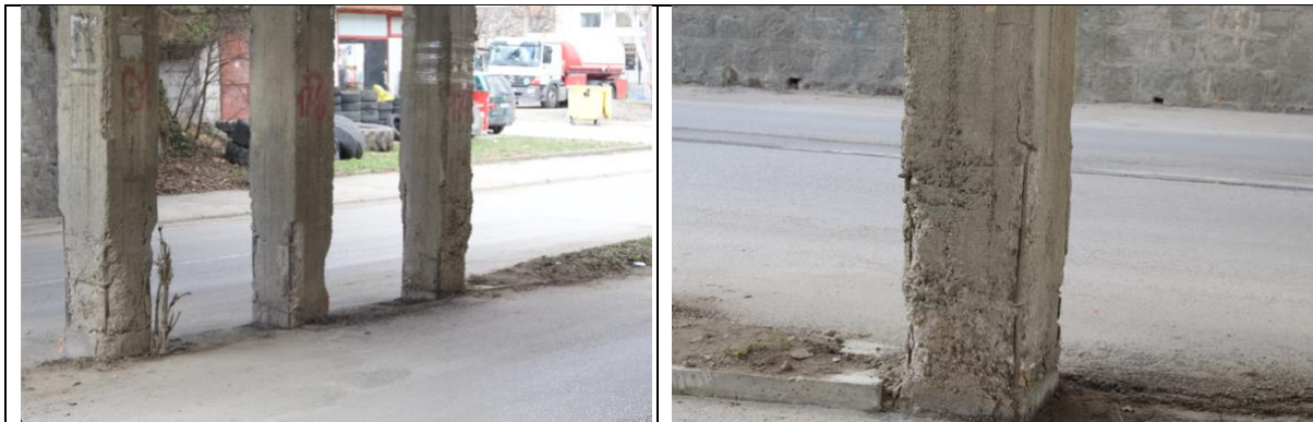
Състояние на основите на мостовото съоръжение
