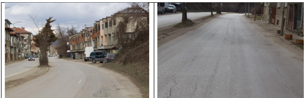
Състояние на пътна маркировка на ул. „Опълченска“
