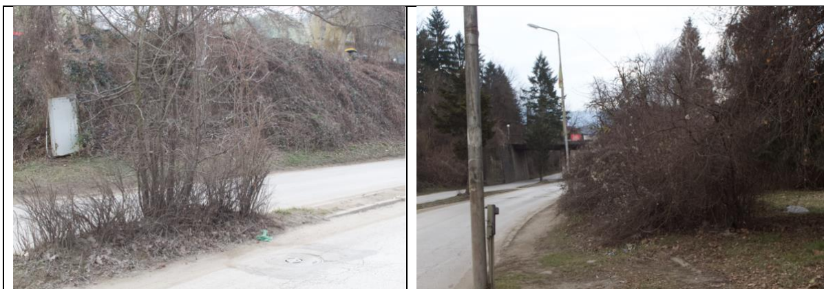
Състояние на растителността при средния разделителен остров и вдясно от платното за движение с посока към ул. „Раковска“
