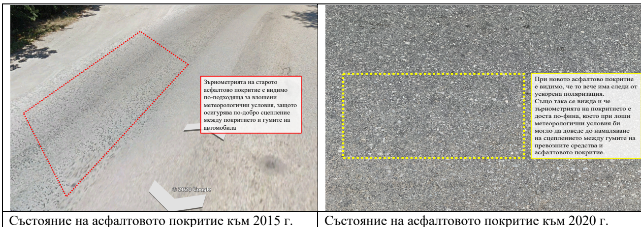
Състояние на асфалтовото покритие към 2015 г. Състояние на асфалтовото покритие към 2020 г.
