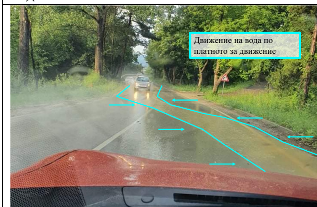
Поради лошото отводняване, при дъжд по-голямата част от водата се задържа върху платното за движение
